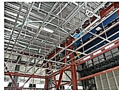
エルメックス-SP 配管状況
