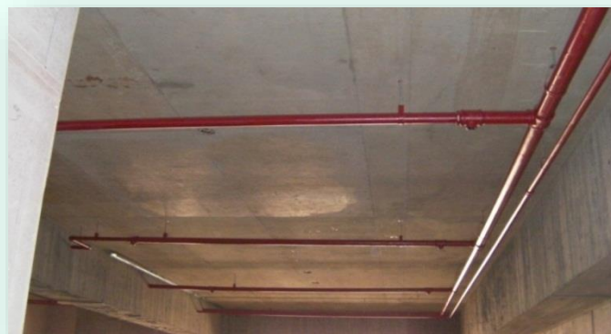
撒水管於天花板下 佔用空間高度
